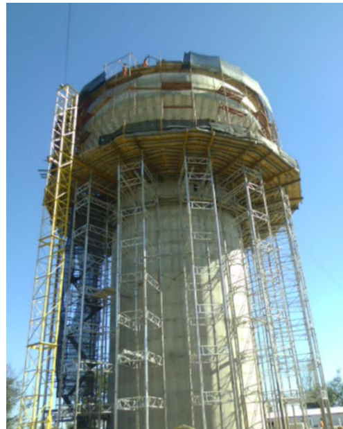
Tanque de almacenamiento de agua
