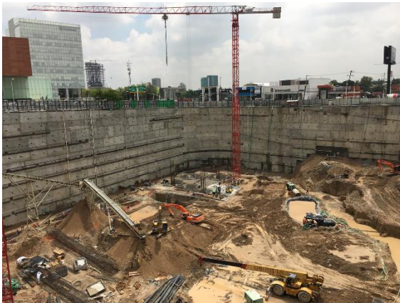
Proyecto Landmark, Guadalajara, Jalisco Losa de Sub-presión y muros con PENETRON ADMIX
