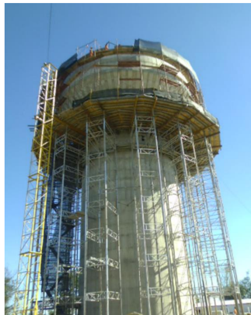
Tanque de almacenamiento de agua
